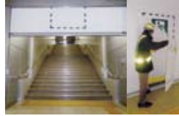
防火防煙シャッター
