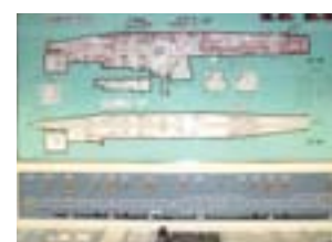
地下線防災監視盤
